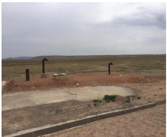
一级泵站闸阀
